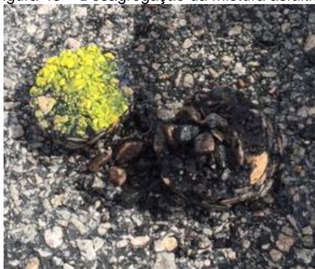
Figura 43 – Desagregação da mistura asfáltica.
