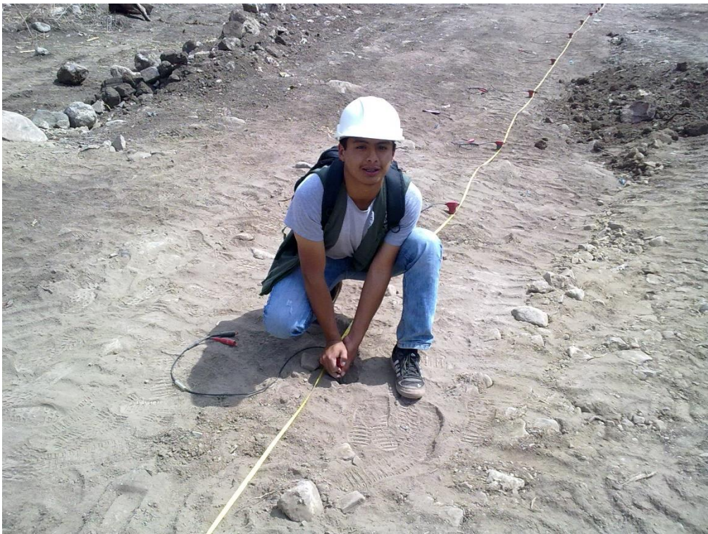
GRAFICO N° 38: Colocación de los geófonos en una distancia de 25m a cada lado del punto de interés.
