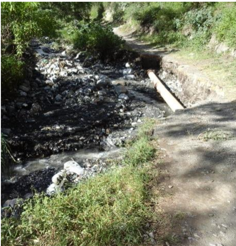
FIGURA N°15: Socavación del Cauce ocasionado por las lluvias máximas.
