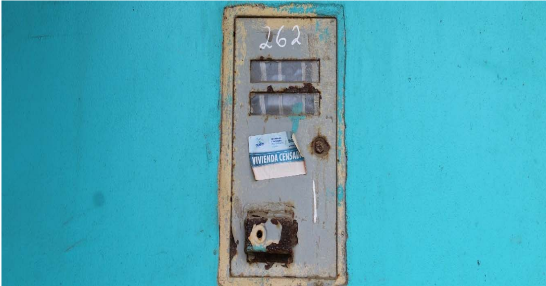
Figura 2.45 Medidor en las Viviendas.
