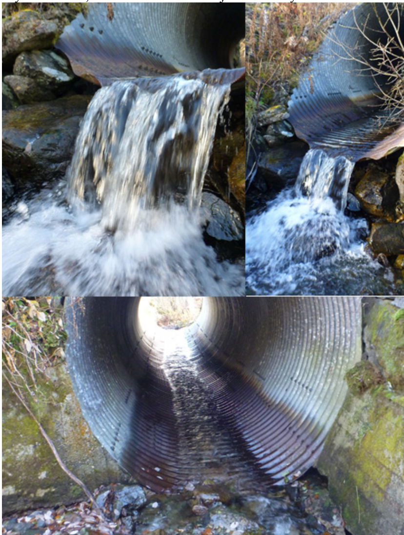
Figur 70. Kulvert under Garbergsveien nedstrøms (over) og oppstrøms kulvert (under). Foto: M. Bergan
