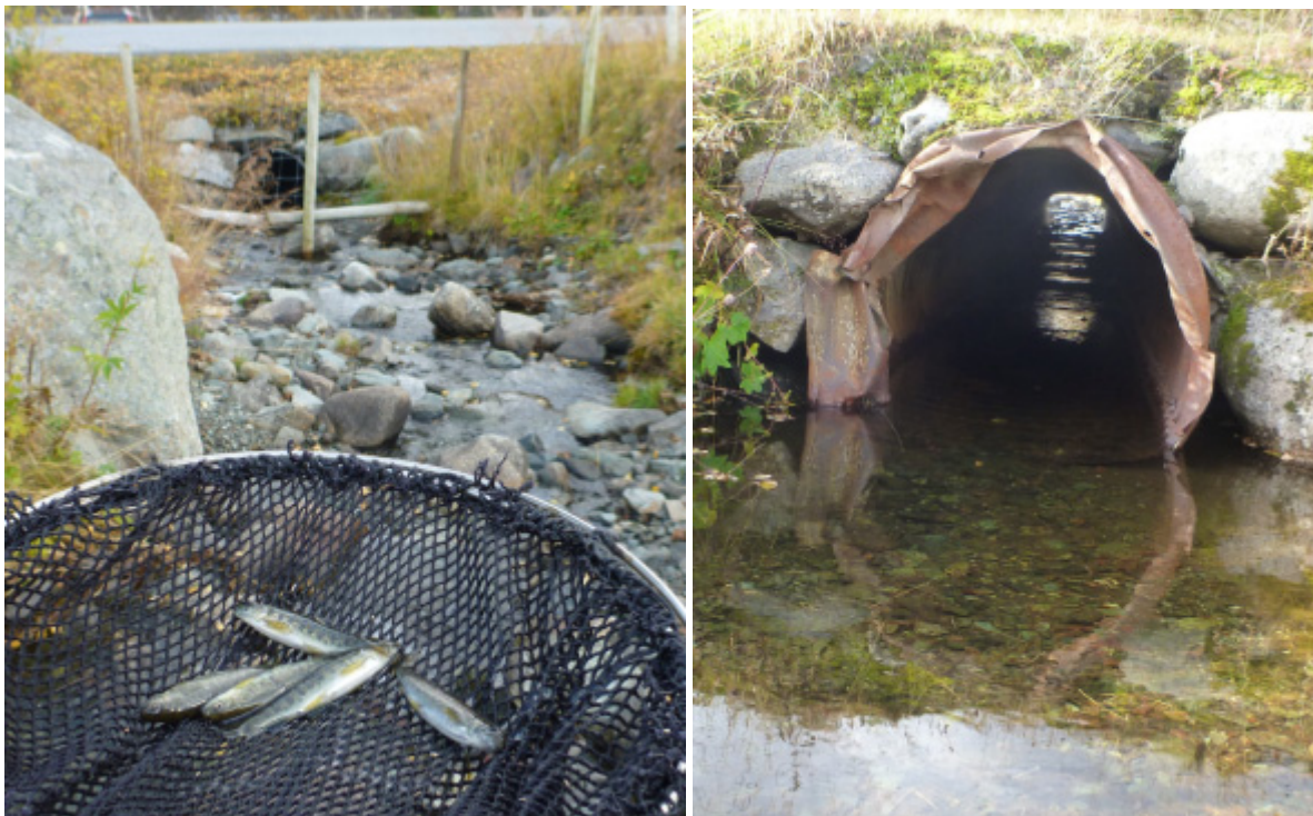
Figur 40. God forekomst av ørret også på strekninger ovenfor Fv 512 i Varghaugbekken (t.v.), og godt nedsenket kulvert under veien (t.h.), som kan passeres av alle størrelser ørret ved normale vannføringer. (Foto: M. Bergan).
