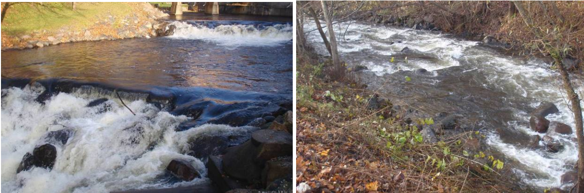
Foto: AKR2. Fosselignede terskler som kan fungere som migrasjonsbarrierer for yngel-/ungfisk og større voksenfisk. AKR 2 til høyre, med svært ugunstige elfiskeforhold, der kun en liten lomme med gunstigere hydromorfologi gir muligheter til å få gjennomført kvantitativt elfiske (foto: Morten Bergan).
