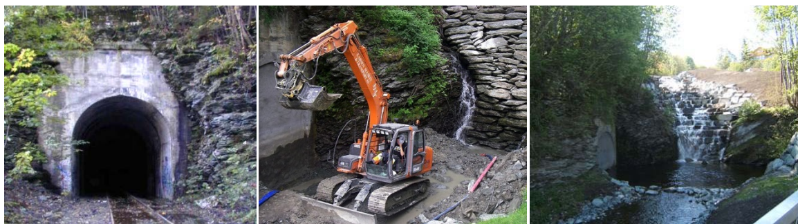
Figur 5. Gjenåpning av Ilabekken. Gammelt jernbanespor ble i 2005-2006 omgjort til kulp og gyteområde for sjørørret. Foto: Trondheim kommune.
