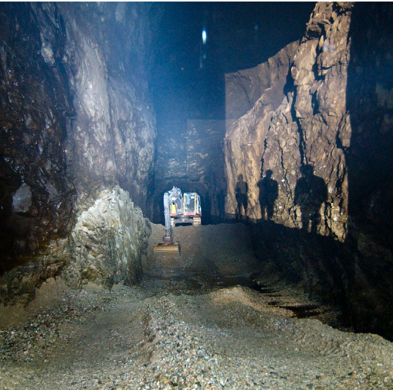
Løsmasser i tunnelsystemet, Tonstad kraftverk. Foto: Kai-Wilhelm Nessler
