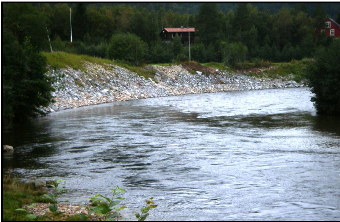
Bilde 8. Denne elveforbygningen i Toåa i Surnadal ble etablert etter storflommen i august 2003, da utgraving av elvemelen gjorde at en lokal vei ble sterkt rasutsatt. Foto: Gunnbjørn Bremset.
