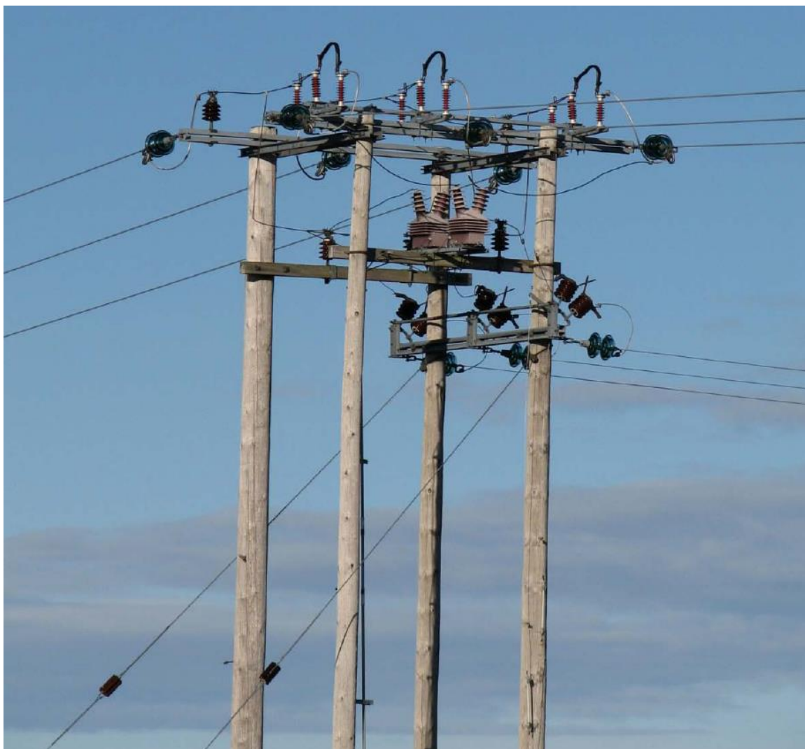
Figur 12. Avgreiningsmaster er konstruert på mange måter. Ofte fremstår de som strukturer hvor fugler finner gode sitteplasser. I åpne landskap med lite skog blir de derfor attraktive utkikksposter for fugler som ønsker å få oversikt og speide etter bytte. Det gjelder bl.a. rovfugl og måker. I kyststrøk, bl.a. på Smøla, er det dokumentert at slike konstruksjoner årlig tar livet av et betydelig antall havørn, kråkefugl og måker ("killerpoles"). Ved å utforme disse på en måte som reduserer attraktiviteten som sitteplass, samt isolere ledninger og traverser, vil problemet reduseres betydelig. Foto: Kjetil Bevanger.
