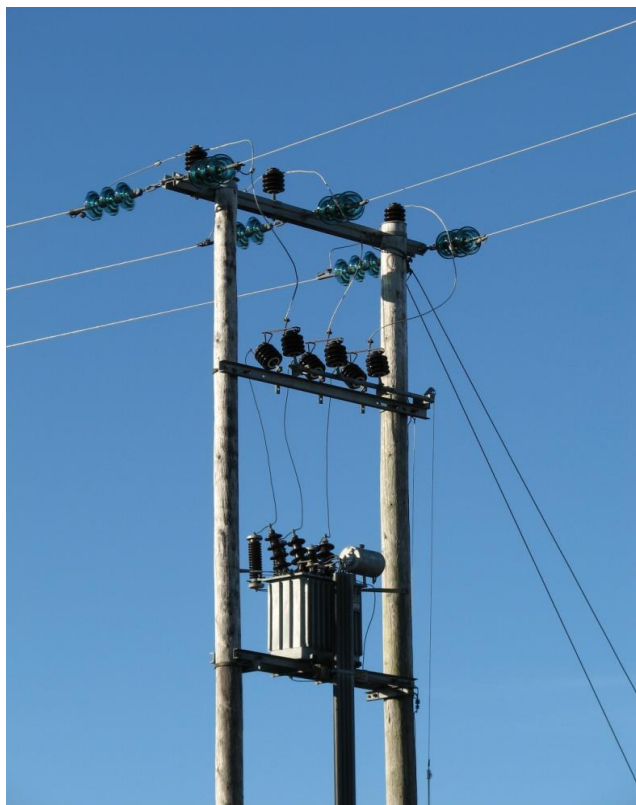
Figur 11. Stolpemonterte transformatorer i distribusjonsnettet er blant de strukturer som oftest forårsaker elektroklusjonsulykker hos fugl pga. de korte avstandene mellom strømførende ledninger og/eller strømførende ledning og jordet komponent. Foto: Kjetil Bevanger.
