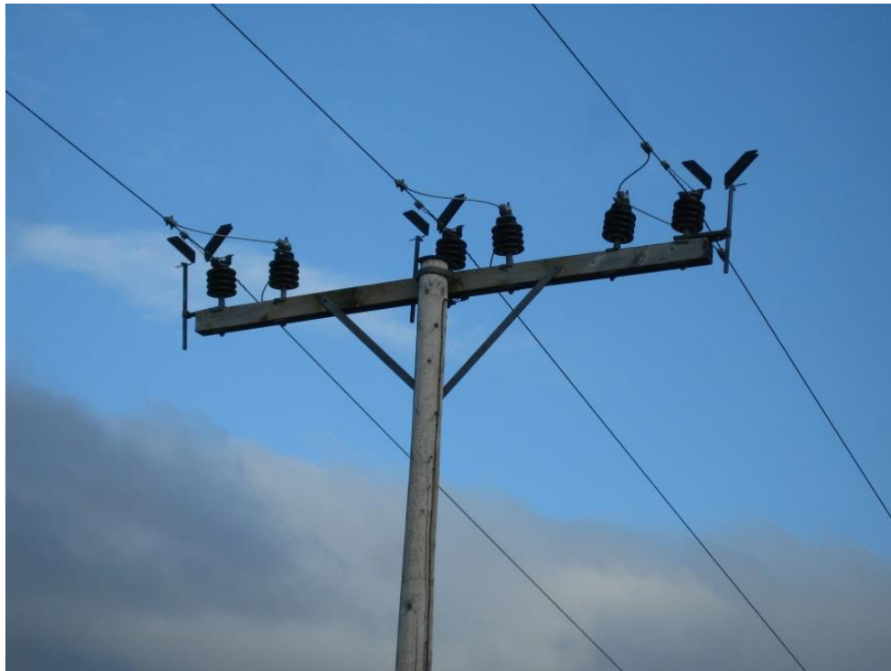
Figur 22. Mast med forsterket oppheng. På tross av fuglevernet på gnisthornet vil den reduserte faseavstanden føre til at fugler blir meget utsatt for elektrokusjon når vingene strekkes ut, og det eventuelt oppstår kontakt fase-fase eller fase-jord (Foto: S. Refsnæs).
