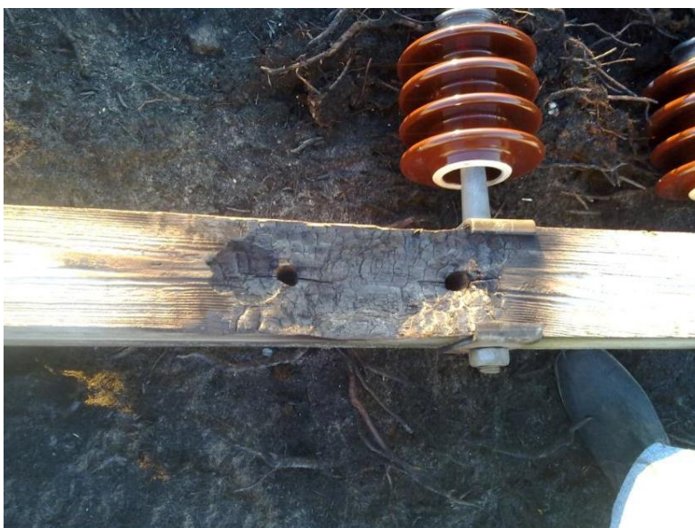
Figur 23. Ulmebrannen skyldes lokal høy strømtetthet i overgangen mellom traversen og stolpen i et 22 kV trefase H-mastarrangement. Den bakenforliggende årsaken var at traversen kom i berøring med faselederen ved den andre stolpen (Foto: P. Berntsen).
