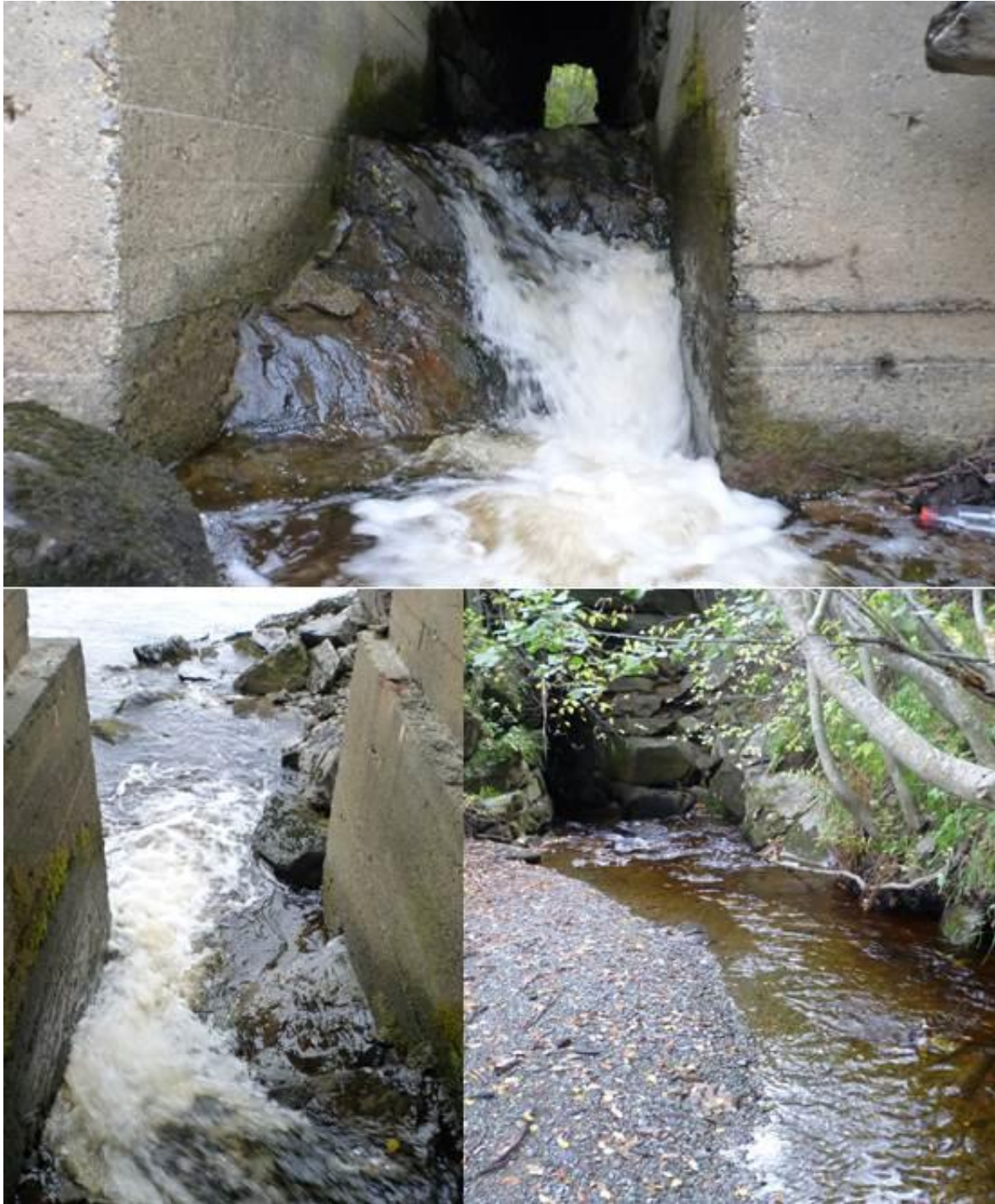
Figur 54. Veikrysning under E6 for Gyllbekken. Øverst og til venstre vises kulvertutløp, nederst til høyre kulvertinnløp. Foto på normal vannføring i Gaula og Gyllbekken. (Foto: Morten Andre Bergan).
