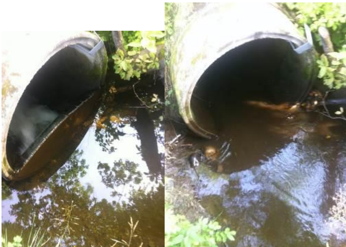
Figur 63. Oppgang til viktige gyteområder i Skårvollbekken var sperret i 2011 (t.v.) slik at kun 250 meter av bekkens om lag 2 kilometer anadrome strekning var tilgjengelig for oppvandrende gytefisk. Sperringen er nå fjernet men det er usikkert hvor lenge vassdraget har vært sperret slik. (Foto: Morten Andre Bergan).
