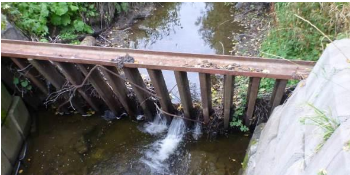
Figur 57. Tetting av rist skaper vanskelige oppgangsforhold for fisk i Ørbekken. Rista var tett i 2008, på befaring i 2011 og nå i 2013. I 2011 flommet Hovinbekken over i forbindelse med. denne kuverten, og 30-40 cm vann sto på veien (Fv. 671 Korgstadveien) som går parallelt med Ørbekken ( www.trønderbladet.no ). (Foto: Morten Andre Bergan).
