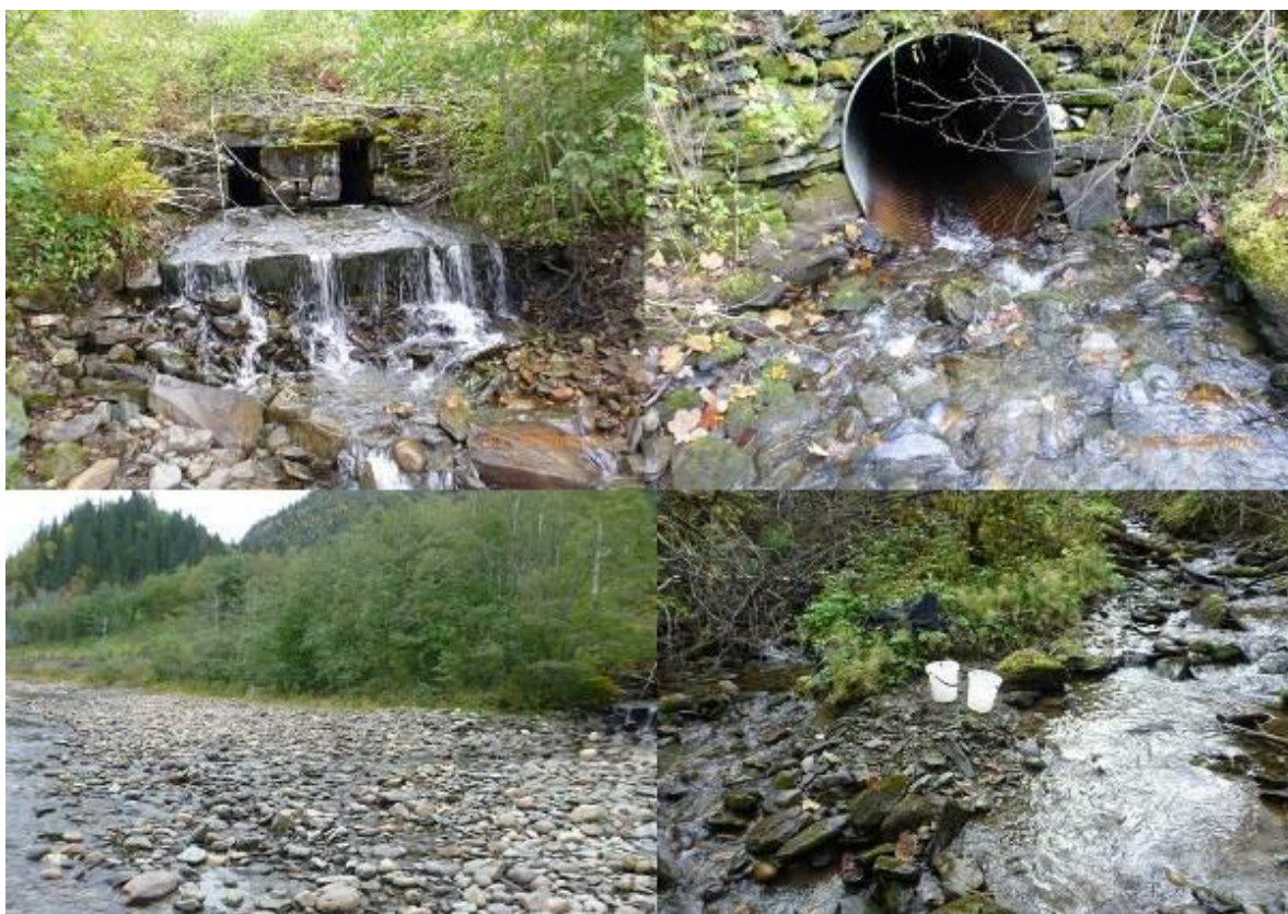
Figur 58. Utløp (øverst t.v.) og innløp (øverst t.h.) i kulvert under jernbane og vei i Bjørkbekken. Det er lang avstand til Gaula opp mot betongkonstruksjonen (under t.v.), og elva må gå flomstor for at sjørret kan nå Bjørkbekkens gytearealer (nederst, t.h.). (Foto Morten Andre Bergan).
