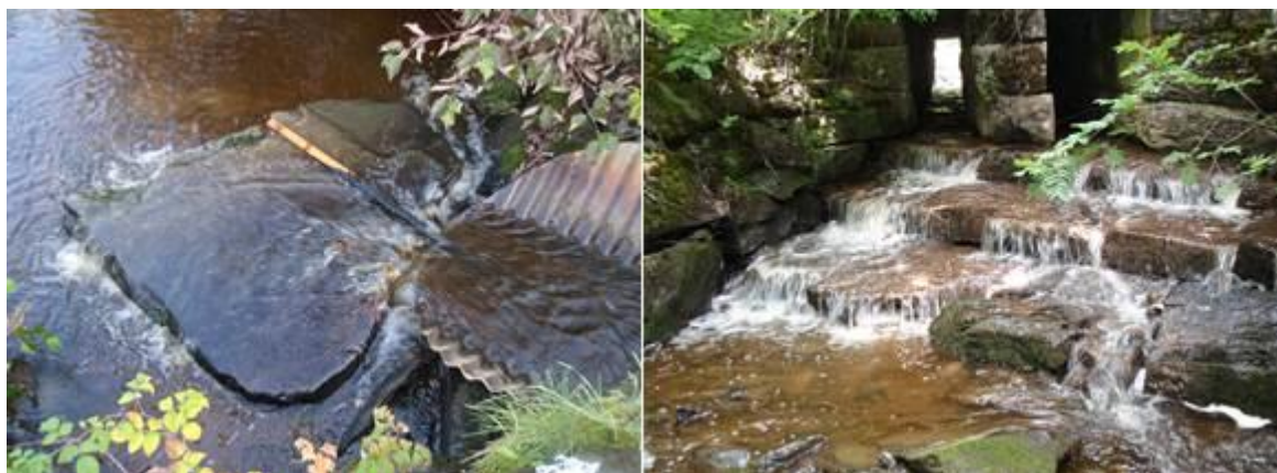
Figur 47. Veikrysning under E6 (t.v.) og stikkrenne under jernbanelinja i Lynga (t.h.). (Foto: Morten Andre Bergan).
