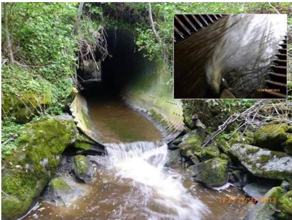
Figur 29. Kulvertkrysningen under Melhusveien er uheldig utformet for oppgang av gytefisk, og har forverret oppgangsforholdene i dette partiet av bekken. (Foto: Morten Andre Bergan).
