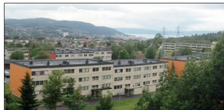
Blokkene har kompakttak med skrånkjært isolasjon. Taket er etterisolert og tekkes på nytt.
