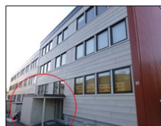
Halvparten av blokkene har søppelrom som er delvis uttrukket, med kuldebroer mot soverom
