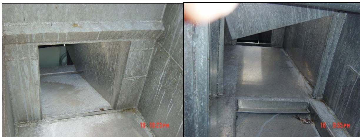
Bilde 6 Innside av fordelingskasser. Vi ser flere skarpe kanter og plater som står 90° i forhold til fartsretningen til fisken.
