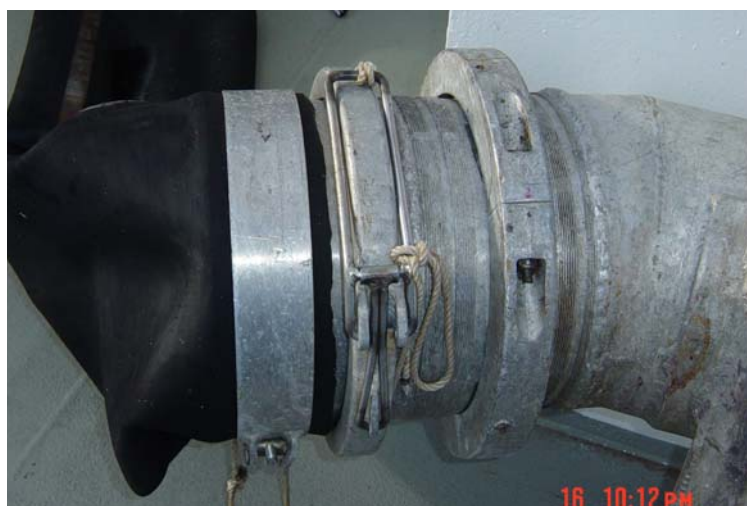
Bilde 8 Skjot mellom gummislange og rør.
