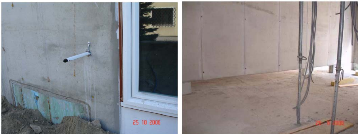
Figur 6 Ytterveggen er løst opp i høyarmerte, korte avsnitt med gjennomgående isolasjon imellom. Til venstre: Et kortere mellomrom ferdig isolert, sett utenfra. Til høyre: Et langt mellomrom mellom to armerte avsnitt før gulvisolasjon er lagt, sett innenfra. Fra "Berichte ...".
