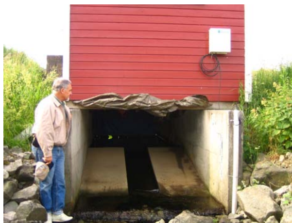
Hovedstasjonen i Skuterudfeltet med Crump-overløp og nedsenket midtseksjon (Foto: J. Deelstra).
