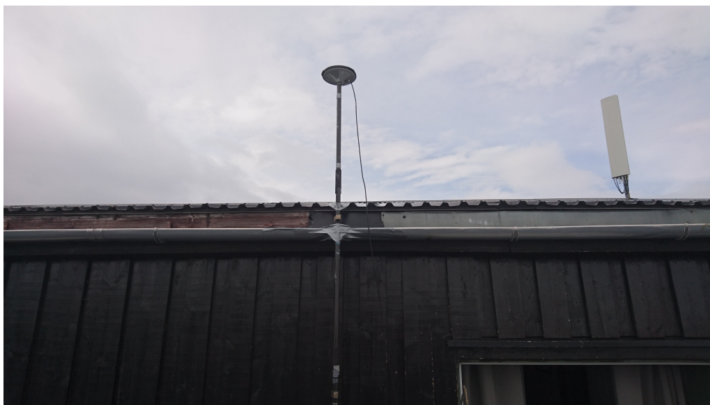
Figur 6.5: Montering av antenna til Septentrio på Juvasshytta
