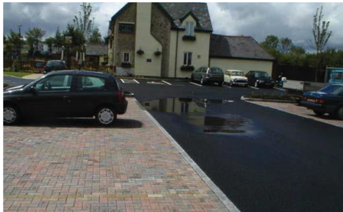
Figur 2.3: Sammenligning av et tett asfaltdekke (t.h) og et permabelt dekke (t.v) (Interpave, 2010)
