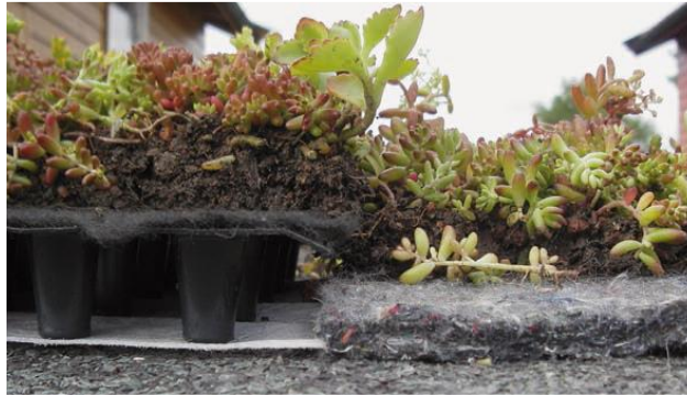
Figur 3.8: Oppbygning av ekstensive tak med drenering, GT1 (t.v) og kun filtmatte, GT2 (t.h) (Braskerud, 2014)
