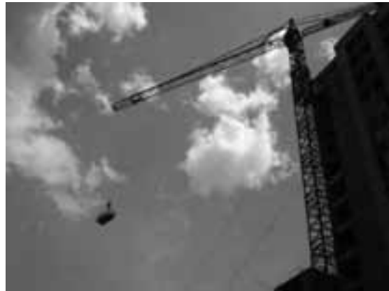
Figura 6. Trabajo en alturas en una torre grúa, utilizada para transportar materiales en la construcción.
