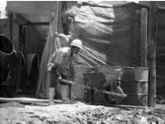
Figura 5. Posición incorrecta al movilizar un medio de transporte en una obra.
