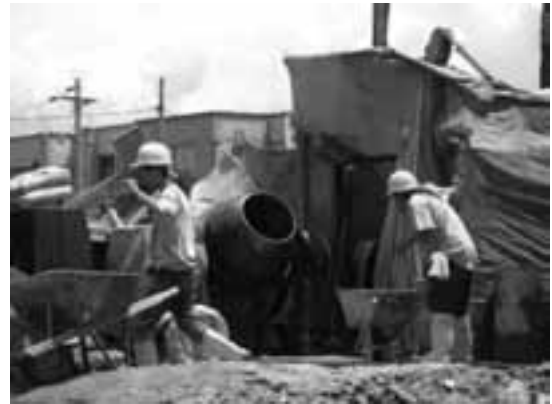
Figura 4. Una fuente de ruido en las obras. Una concretadora o mezcladora es generadora de ruido, sobreesfuerzos y material particulado.
