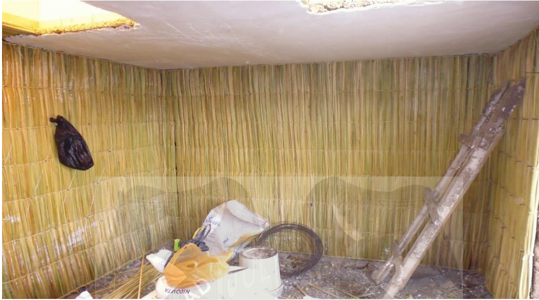
VISTA 21: SE OBSERVA EL COLOCADO DE LA K'ESANA DE TOTORA COMO AISLANTE TERMICO EN LOS MUROS EN EL INTERIOR DE LA VIVIENDA
