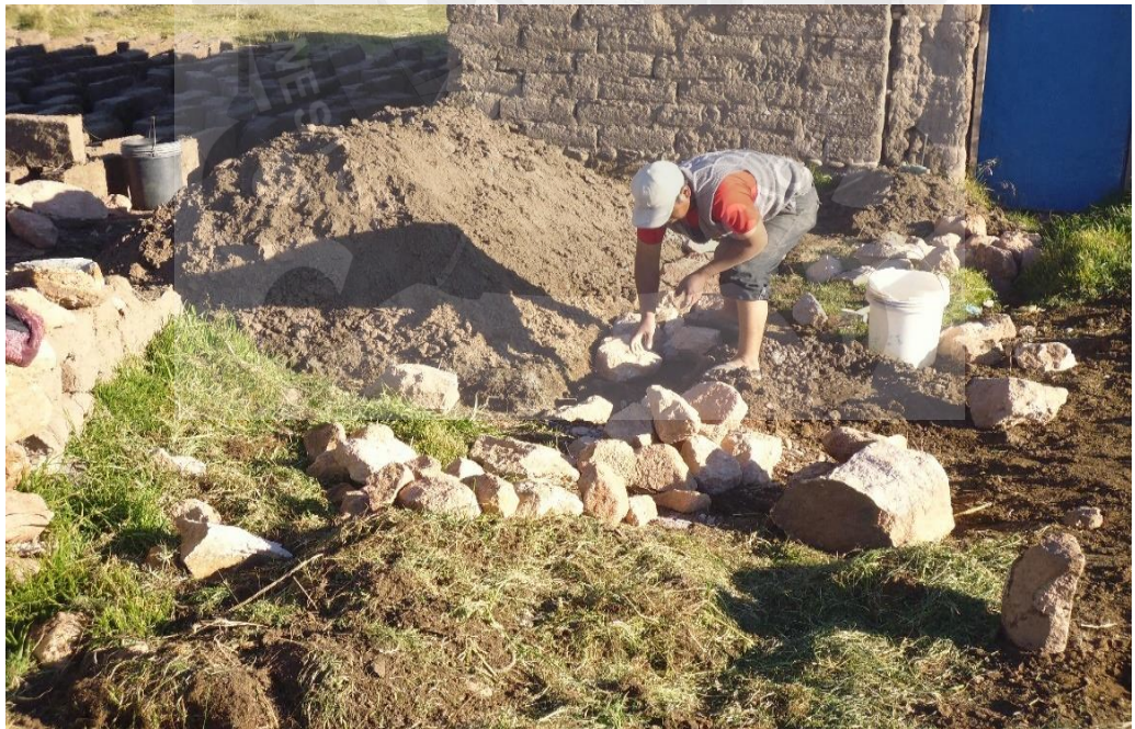
VISTA 14: SE OBSERVA LA CIMENTACION CON MAMPOSTERIA CON MORTERO DE BARRO
