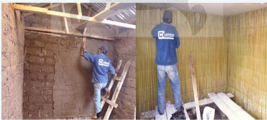
En el lado izquierdo se visualiza en tarrajeo con mortero de barro y al lado derecho se visualiza el colocado de la K'esana de Totora
