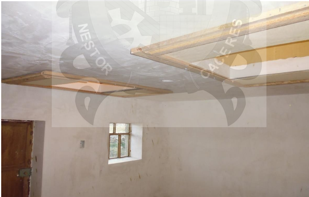
VISTA 26: SE OBSERVA EL COLOCADO DE LAS TAPAS Y VIDRIO EN LAS ABERTURAS DE LA CLARABOYAS
