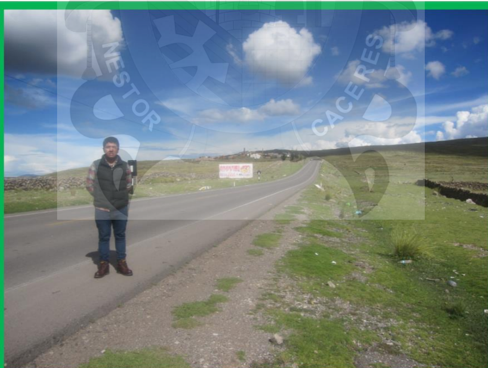
FOTOGRAFÍA 10: Se observa la falta de mantenimiento en bermas, con empleo de suelos de cantera, km. 14+000 de la vía Puno – Juliaca.
