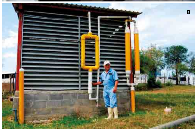
Figura 10. A: Motogenerador a base de biogás de la granja María Ana. B: Filtros colocados verticalmente y trampas de agua.
