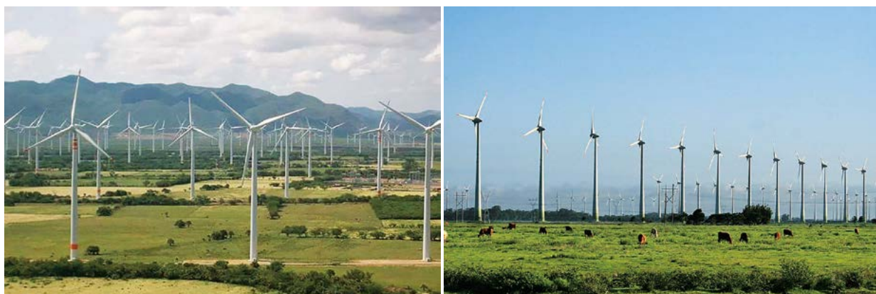
Figura 3. Aerogeneradores instalados en el ejido de la Venta, Juchitán, Oaxaca. Fuente: Tomado de http://www.amdee.org/Amdee/AMDEE_presentacion_esp.pdf
