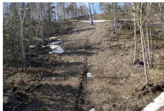
Рис. 11. Просадки грунта в кабельной канаве
