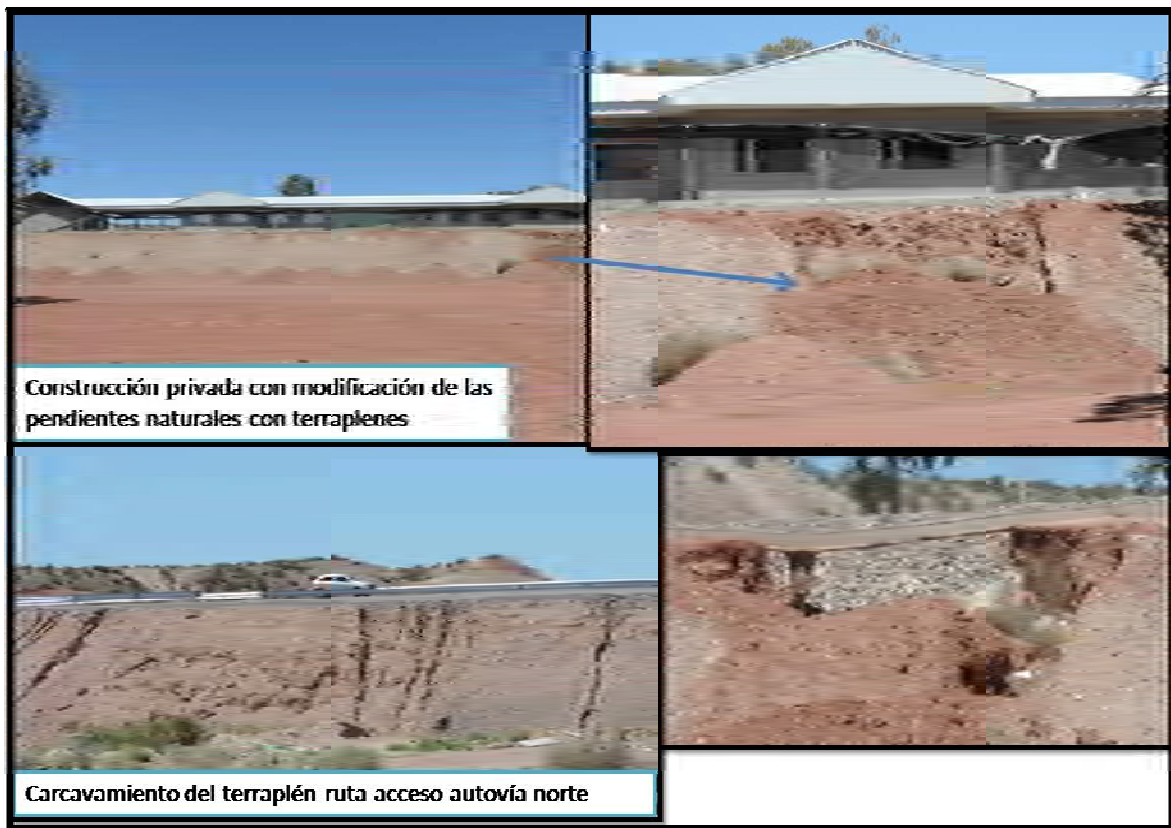
Figura 8.10: Obras con problemas al imponer nuevas pendientes no naturales.
