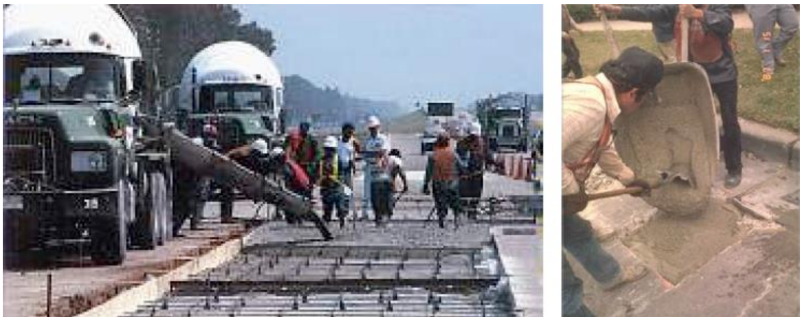
Figura 5. Uso de geopolímeros con cemento portland (cemento híbrido) como material reparador de pavimentos.
