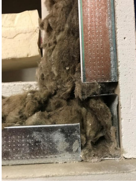
Figura 73: Vista de la col·locació de la paret de pladur, la guia metàl·lica i la llana de roca. Font: Pròpia
