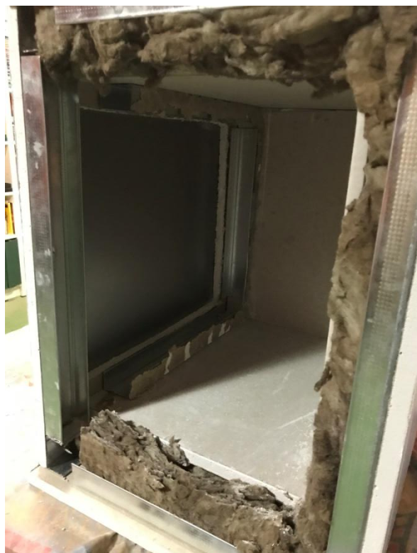
Figura 77: Vista lateral del interior de l'estructura amb la planxa metàl·lica instal·lada. Font: Pròpia
