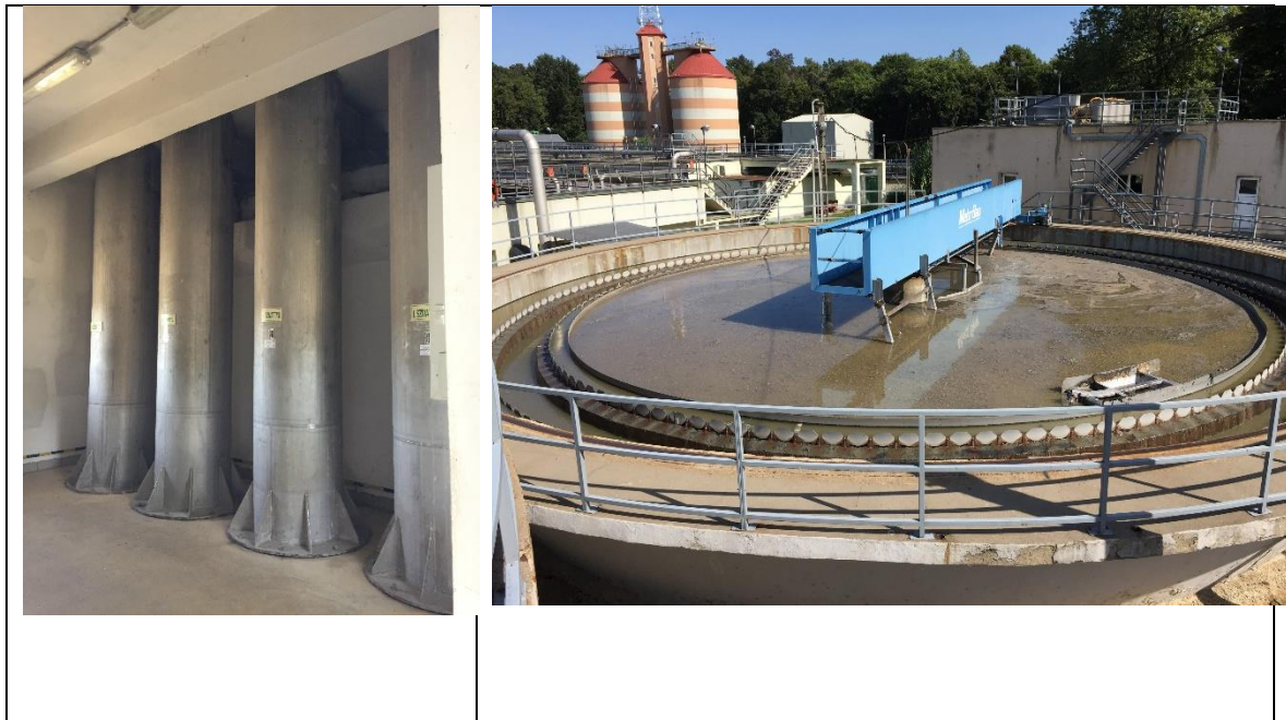
Ábra 7.1: Csőszivattyúk a befolyó területen és az előülepítő, Nyíregyháza
