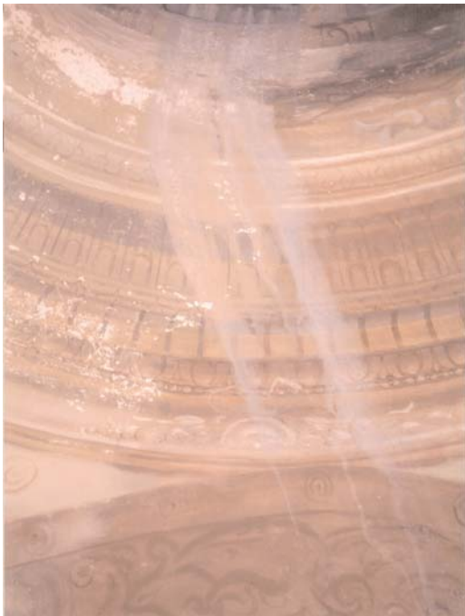
Cúpula del coro. Sustancias depositadas sobre las pintruas como consecuencia de la entrada de agua de lluvia por las ventanas
