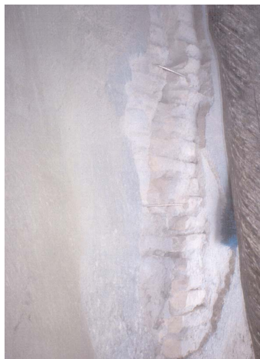
Rehabilitación de la cúpula central en 1999. Detalle del cosido exterior de una grieta.
