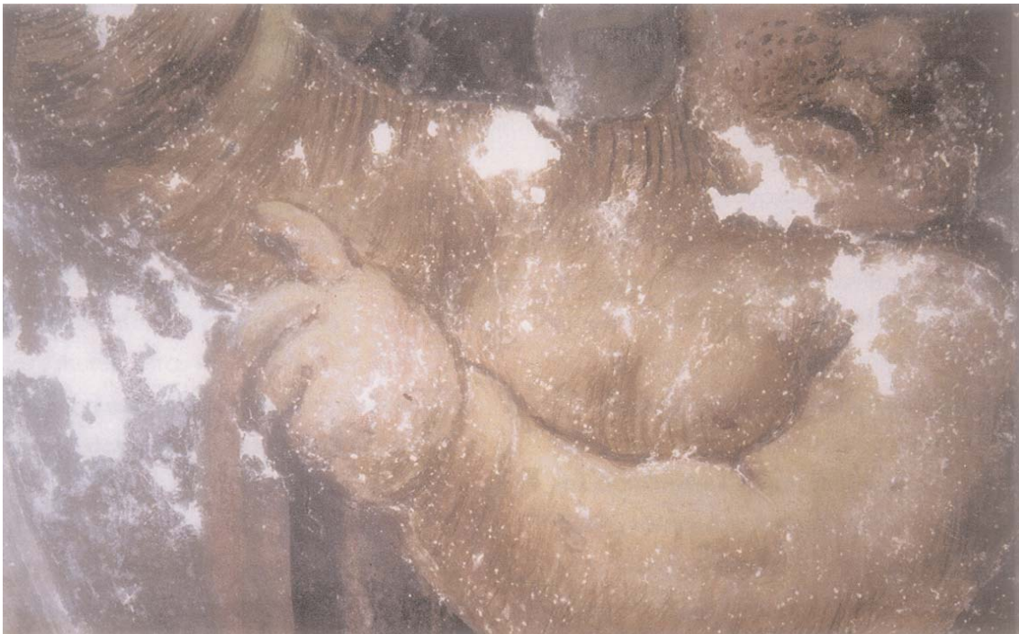
Pechina norreste de la cúpula de la Epístola. Degradación en forma de pequeños puntos como consecuencia de la sulfatación del enlucido de cal
