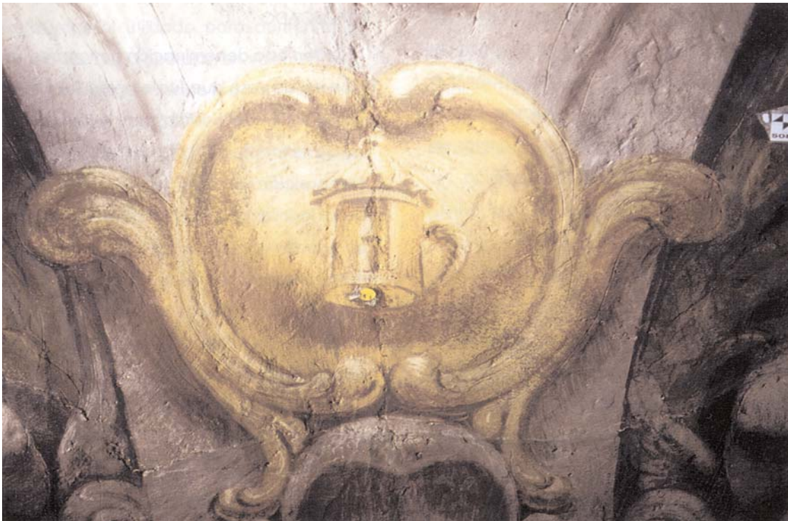
Cúpula del crucero de la Epístola. Detalle del fresco donde se aprecian las señales de las jornadas "alla Vèneta", y restos de los fijativos a la cola-caseína aplicados mediante pulverización sobre las pinturas.
