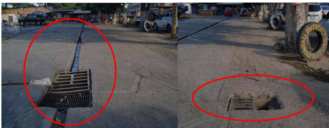
Figura 32. Huecos de alcantarilla como obstáculos en la red
