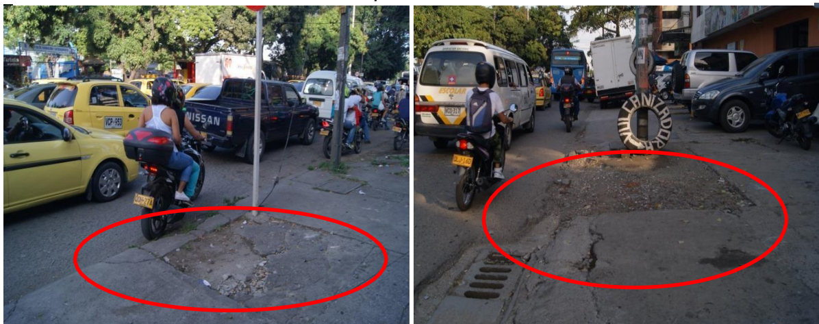
Figura 31. Los andenes están deteriorados y los límites con la calzada se han perdido.
