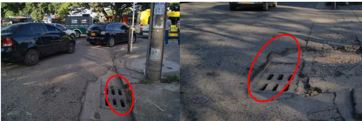
Figura 14. Drenaje deteriorado, por debajo de la rasante
