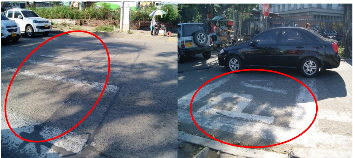
Figura 21. Demarcación desgastada, perdida de la reflectividad
