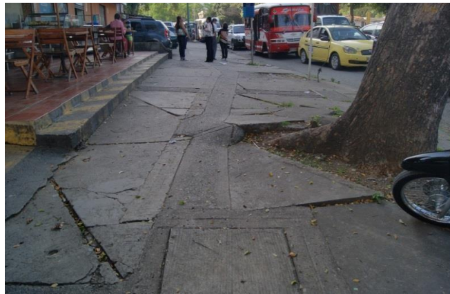
Figura 25. La zona peatonal costado sur también carece de iluminación artificial, solo el paso por la clínica cuenta con la iluminación suministrada por la propia clínica
