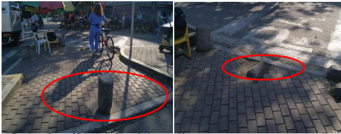
Figura 33. Bolardos obstaculizando el paso peatonal.
