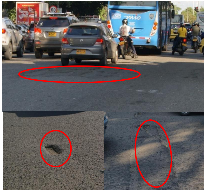
Figura 28. Huecos y pavimento deteriorado.
