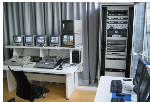
Regieraum: Bild- und Tonmischung, Kamera- und Medienraum-Steuerung, Signalverteilung; im Vordergrund rechts: Encoding-PCs
