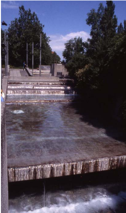
Abbildung 167: Gesamtansicht der Kaskade an der Münchner Freiheit
