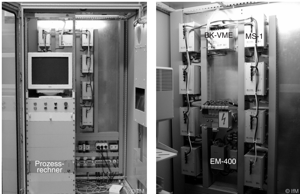
Bild 3.31: Schaltschrank für die Magnetführung der Maschinenachse
