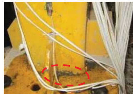
(d) Weld fracture at CFST column base
