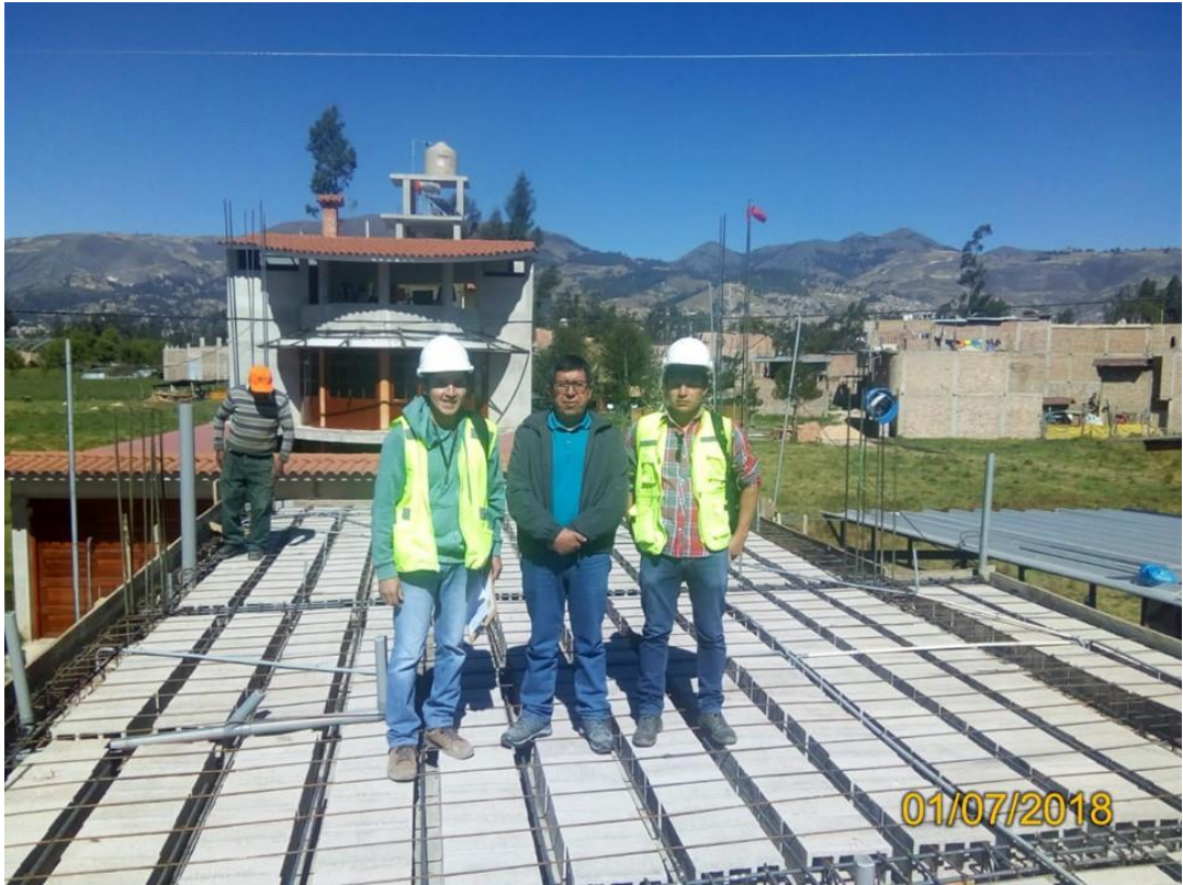
Fotografía 11. Control de cantidad de agua de losa N° 17 en Jr. Las Auroritas S/N – Cajamarca.
