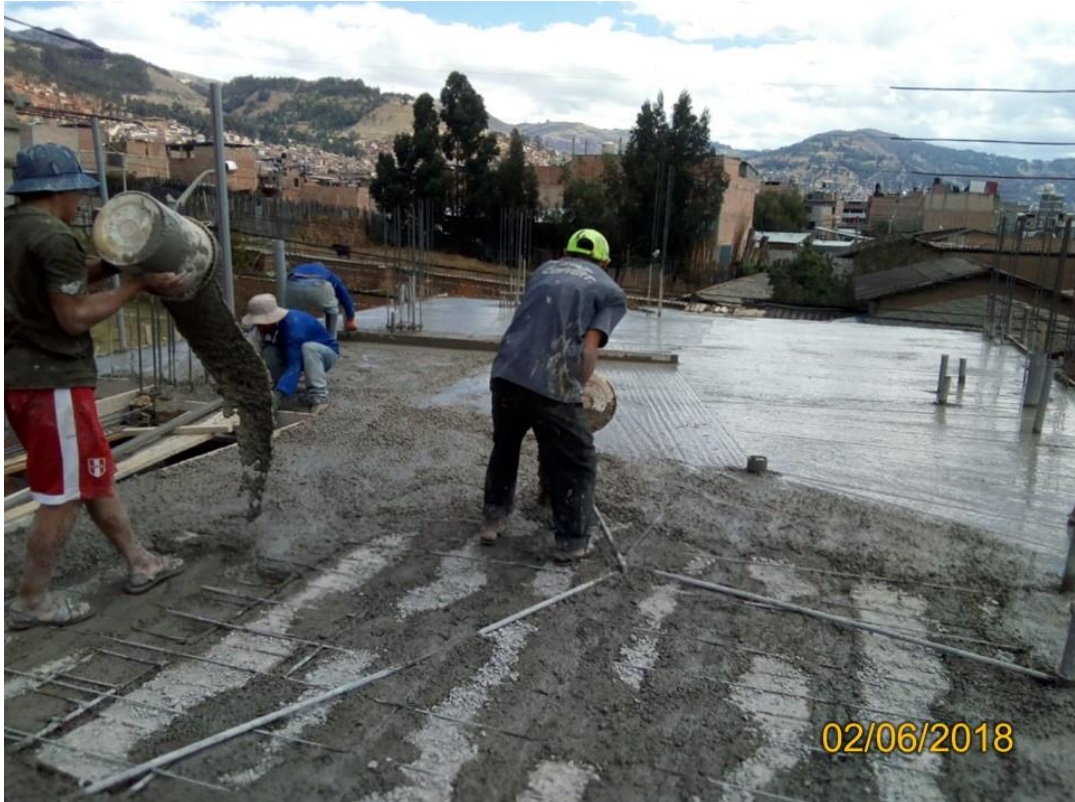
Fotografía 1. Vaciado del espesor de losa aligerada sin EPP y con una mezcla de concreto de consistencia líquida en Av. Independencia S/N – Cajamarca.
