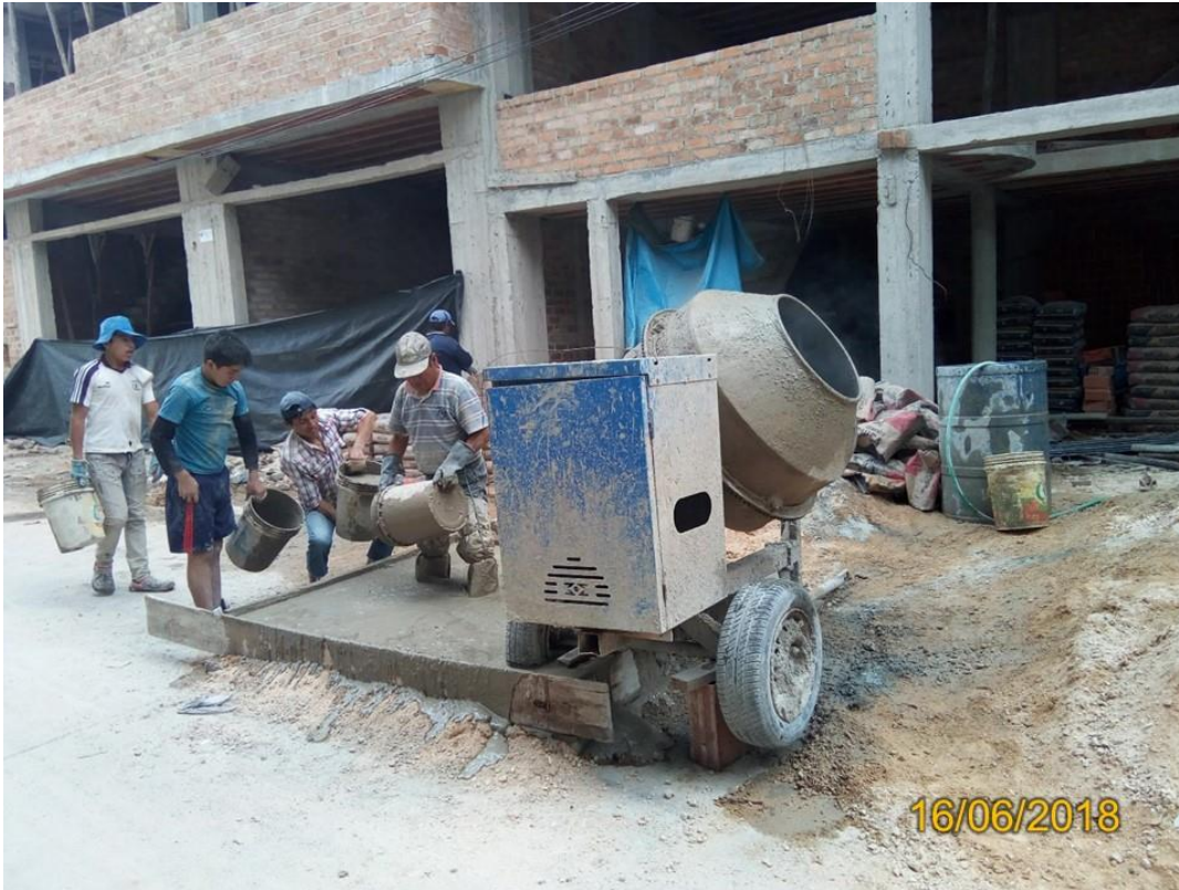
Fotografía 9. Llenado de los baldes para el traslado de concreto en losa aligerada 11 del Jr. Von Humbolt C3 – Cajamarca.
