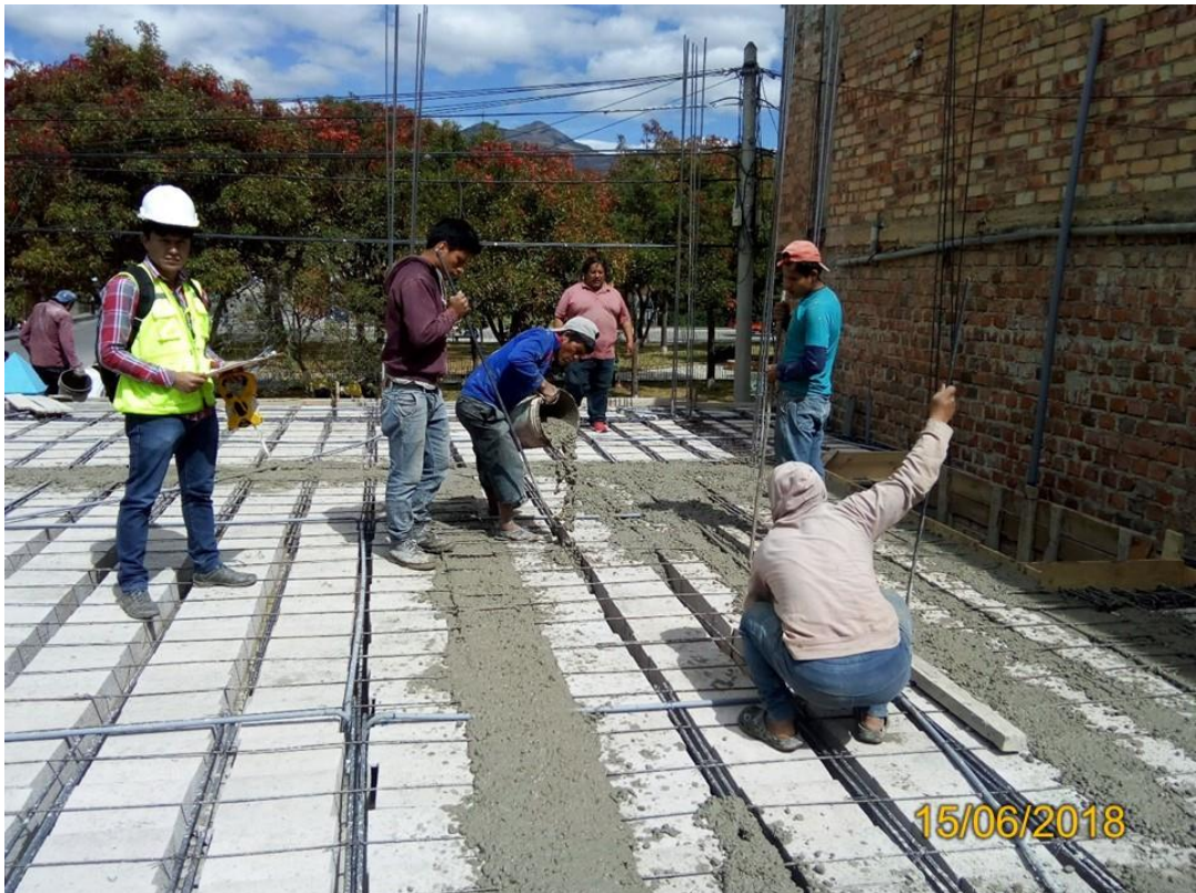
Fotografía 4. Registro del número total de la cuadrilla para el vaciado de losas en el Jr. Mariano Ibérico N° 321 - Cajamarca.
