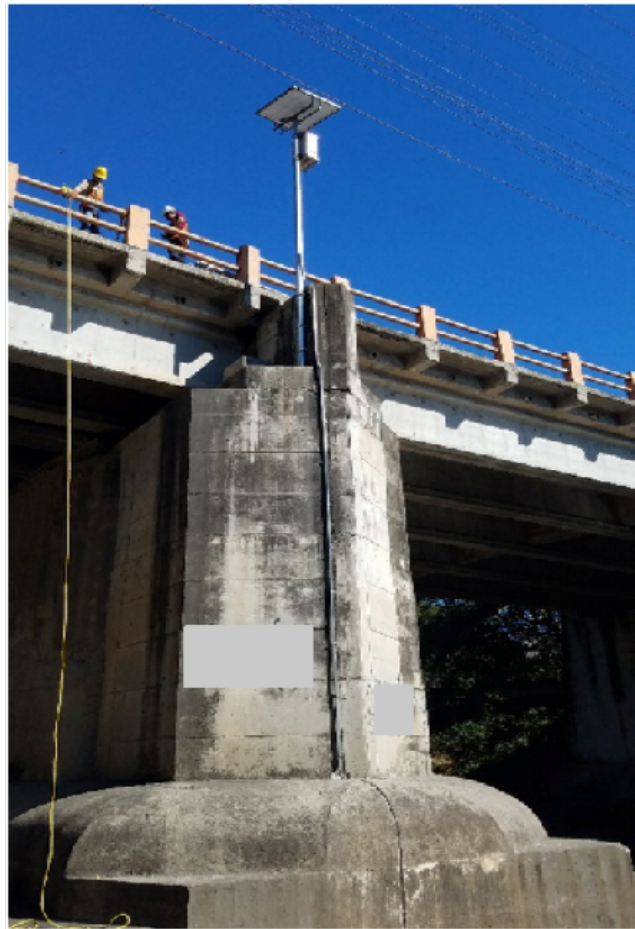
Figura 3. Vista panorámica, estación hidrométrica, instalada, con su fuente solar fotovoltaica.
