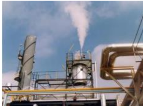
Figura 33: Imagen del desgasificador
