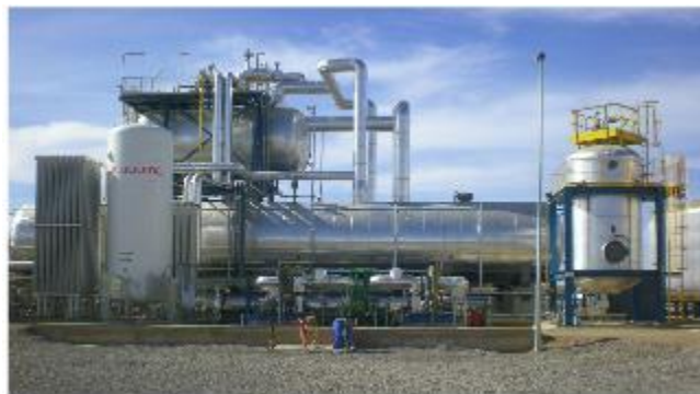
Figura 24: Tanque de expansión
