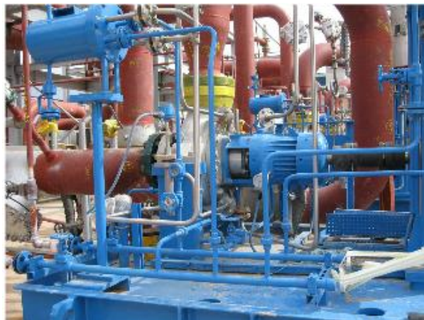
Figura 25: Sistema de bombeo
