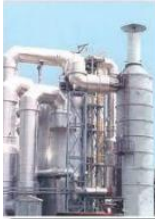
Figura 34: Imagen del desgasificador
