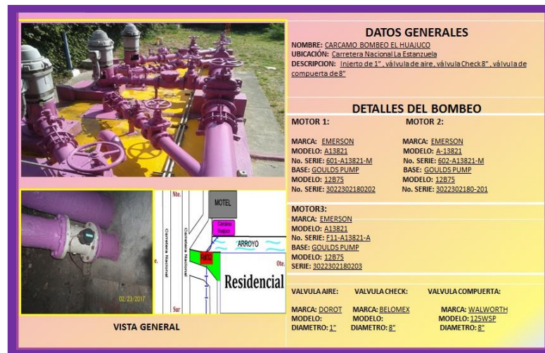
Figura 4. 29 Cárcamo Huajuco, enlace entre P´tar Santiago y P´tar San Rafael.
