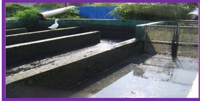
Figura 4. 20 Presencia de sólidos y lodos en cámara de contacto de cloro en P'tar Santiago.
