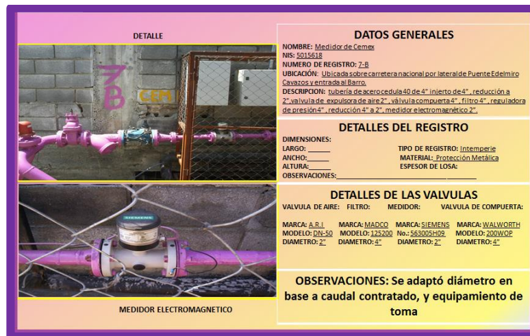
Figura 4. 38 Equipamiento de toma domiciliar en el SAART.
