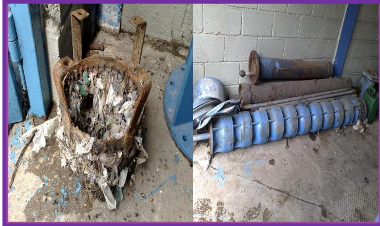
Figura 4. 24 Cedazo de bomba dañada por atascamiento en P'tar Santiago.
