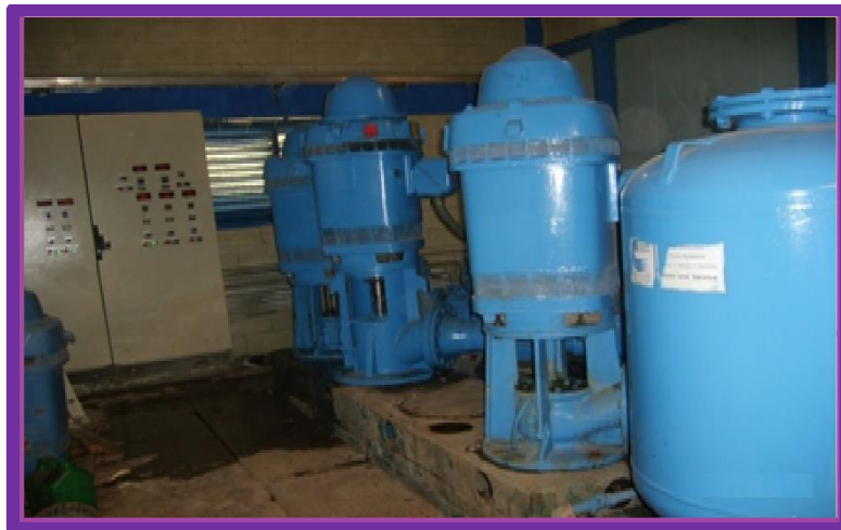
Figura 4. 25 Centro de control y motores de cárcamo inicial en P'tar Santiago.
