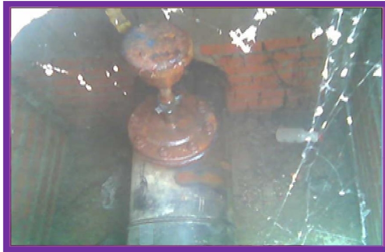
Figura 4.31 Válvulas inadecuadas de admisión-expulsión de aire en SAART.
