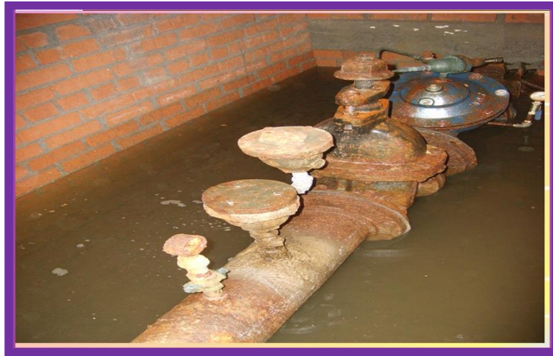
Figura 4. 33 Conexión sobredimensionada y equipamiento inadecuado en SAART.
