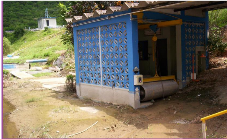
Figura 4. 23 Sistema de desinfección mediante cloro gas en P'tar Santiago.
