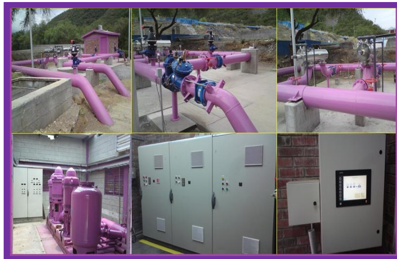
Figura 4. 26 Conjunto de Centro de Control Electromotriz y protección en Cárcamo de P'tar.
