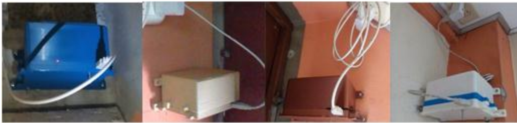
Ilustración 28. Nodos instalados en cada uno de los 4 pisos del edificio D.
