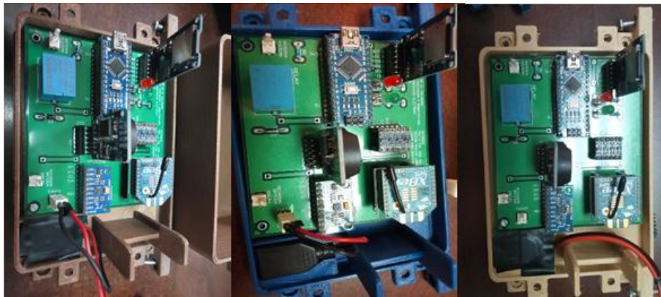
Ilustración 27. Nodos sensores momento previo a ser instalados en el edificio D.
