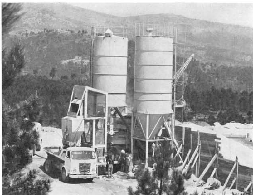
Fig. 16. Central de hormigonado Lambert, de 25 m 3 /hora.
