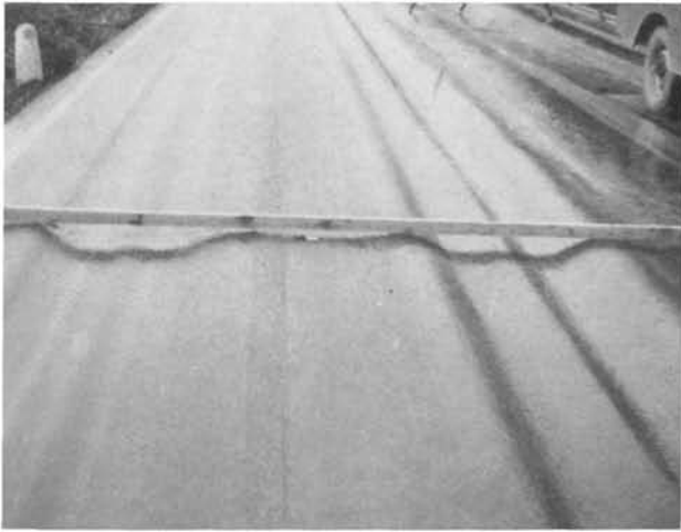
Fig. 6. Rodadas en una rampa de subida del mismo puerto de la figura 5.
