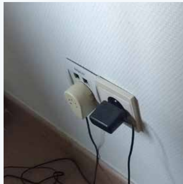
Figuur 3.15 Openingen in de wand voor stopcontacten, waarlangs luchtgeluid zich kan voortplanten. (De stopcontacten in de andere kamer werden op dezelfde locatie geplaatst.)
