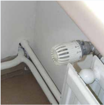
Figuur 3.12 Akoestisch lek via de doorvoer van de centrale verwarming.
