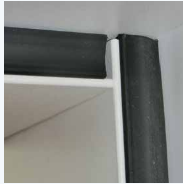
Figuur 3.13 Slecht afdichtende rubbers in deur- en raamkozijnen.
