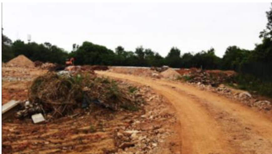
Figura 13 - Reutilização de Resíduos Classe A como agregado para pavimentação de base e sub-base
