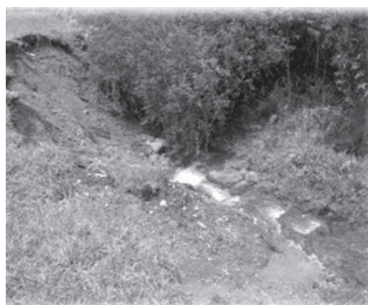
Figura 3. Deslizamiento de tierra en la fuente de abastecimiento La Moya.
