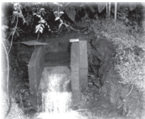
Figura 4. Bocatoma fuente de abastecimiento Bellavista.
