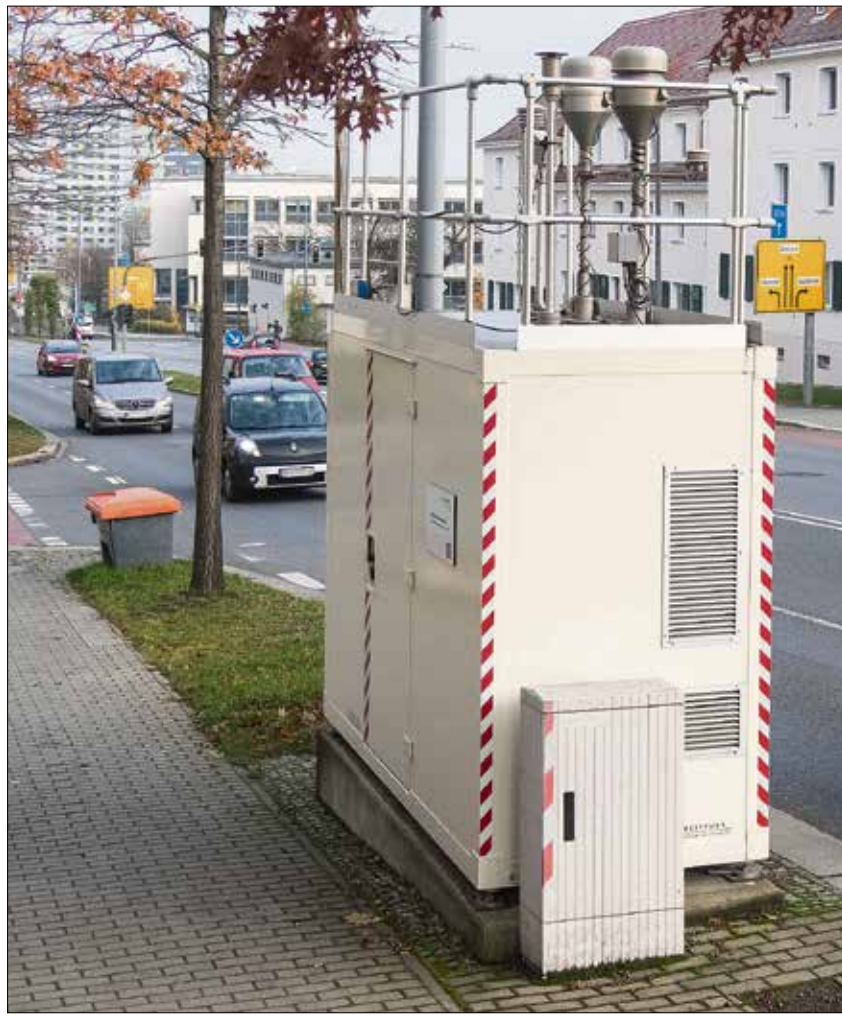
Luftgütemessstation auf der Bergstraße.
