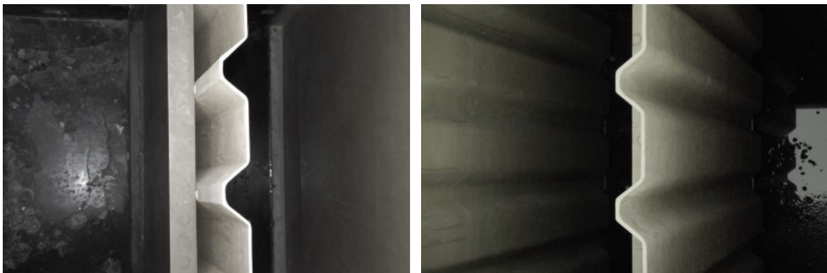
Abbildung 4.5: Schwallwände zwischen den Kammern des ABR (Fließrichtung von links)
