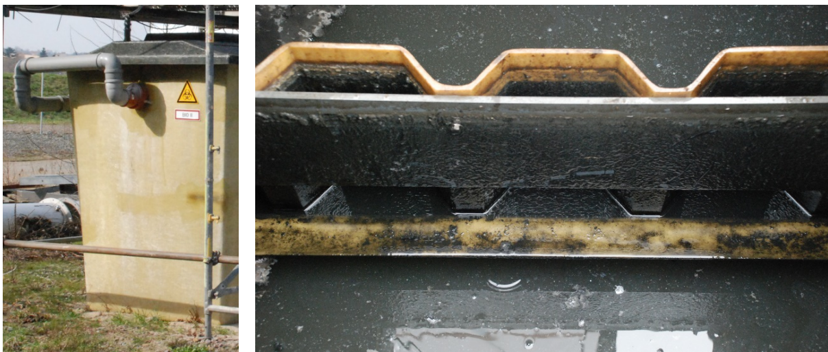
Abbildung 4.28: Geänderte Wasserführung nach Installation von PVC-Platten zwischen den Kammern (Zustand bei auf Höhe der Überfallkante abgesenktem Wasserstand) und Anhebung des Wasserstands durch Einsetzen eines Rohrbogens in die Ablaufleitung
