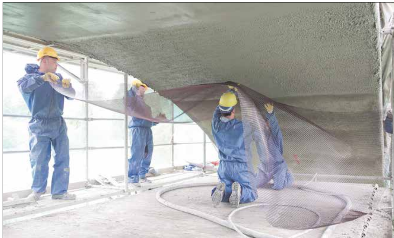
Carbonbeton eignet sich auch hervorragend dafür, bestehende Bauwerke zu verstärken. Seit 2006 wird das entsprechende Verfahren bei alten Bauten angewandt. Im Foto wird mit dem Verbundbaustoff eine Brücke im oberfränkischen Naila saniert. Foto: Jörg Singer
