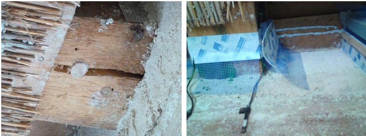
Abb. 12 Dübel zum Verschließen der Längsrisse und mit Putz geschlossener Luftspalt
