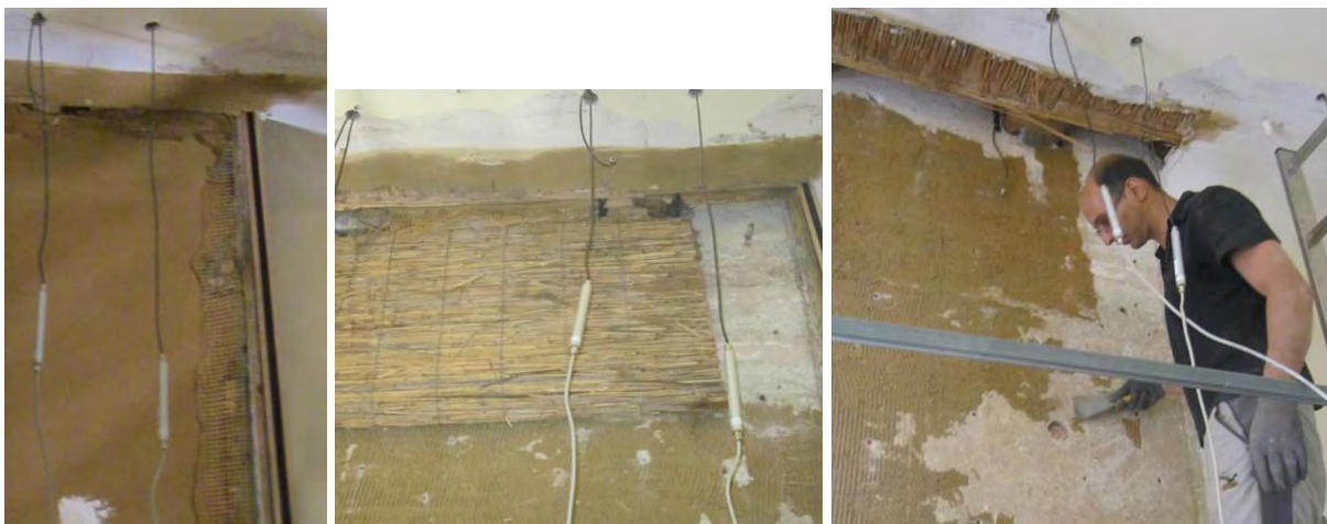
Abb. 30 Links zeigt den verputzten Zustand. Anschließend wurde der Lehmputz von der Schilfdämmung geklopft und mit dem Armierungsgewebe vollständig abgezogen. In weiterer Folge Auslösen der Schilfplatten und Abscheren des Lehmklebers vom Untergrund.
