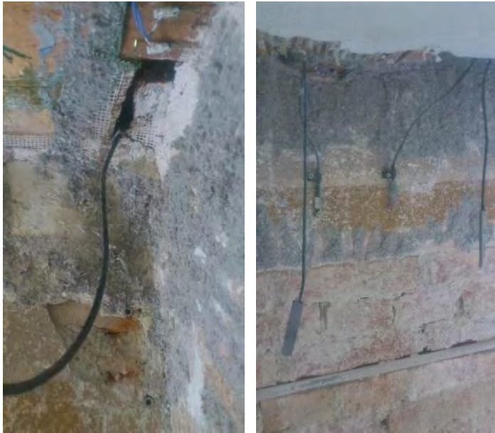
Abb. 33 Zellulosedämmung: links Kabel des rechten Temperatur/Luftfeuchte ‚BA-St‘ Sensor noch in Balkentasche, rechts herunterhängende Kabel der Luftfeuchte-/Temperatur-Sensoren ‚BA-St‘, ‚BA-Wa‘ nach Herausziehen der Sensoren
