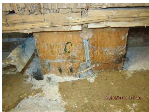
Abb. 32 Holzweichfaserplatte nach Entfernen von Dämmung und Dichtband: Verschluss eines Risses mit einem eingeleimten Holzdübel und dauerelastischer Dichtmasse
