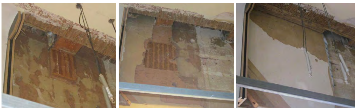
Abb. 29 Abbruch der Holzweichfaserplatte: links ist die gute Haftung des Dünnputzes auf der Holzweichfaserplatte zu sehen. In weiterer Folge stückweiser Abbruch und das Haftenbleiben von Materialstücken auf der Wand
