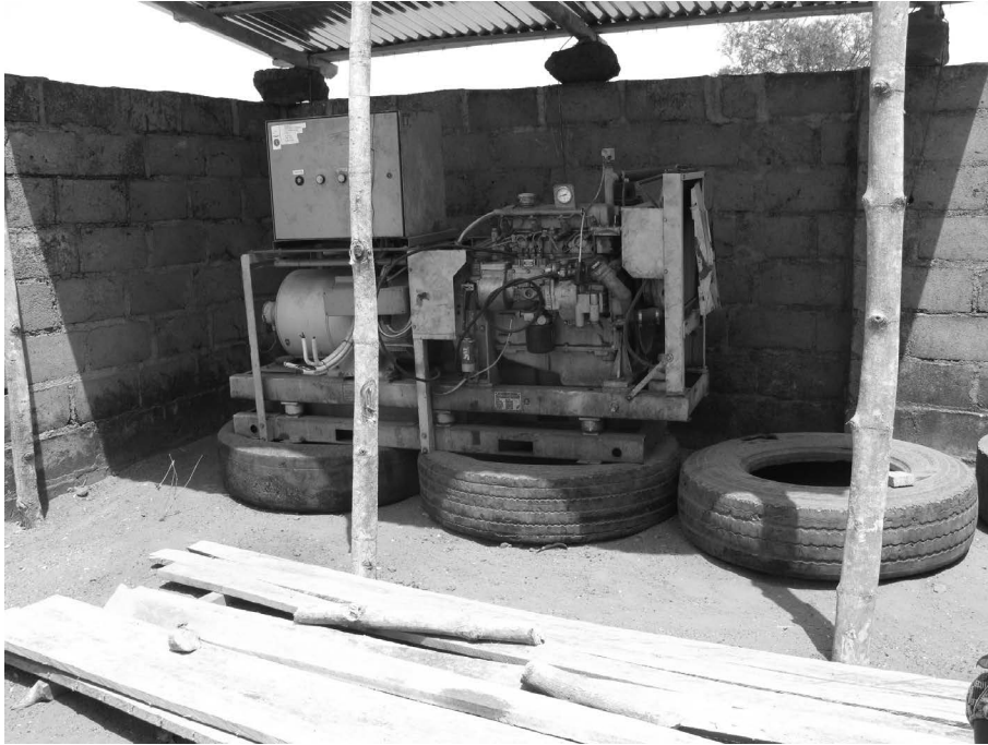
Abbildung 2: Energiesystem Dieselgenerator als einzige Stromquelle zur Baustellenversorgung
