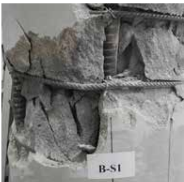
Bild 14: Versagensbild für das Bewehrungskonzept I [Foto: Daniel Busse]
