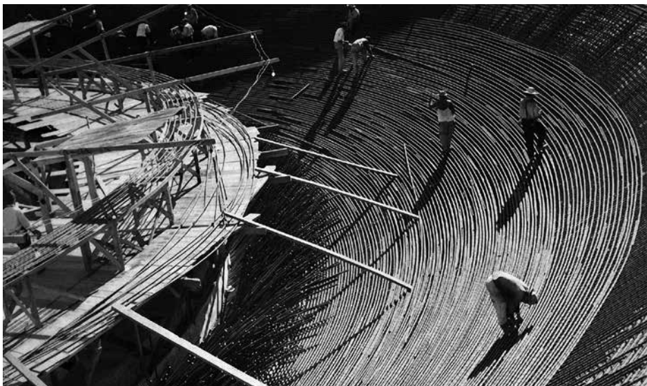
Bild 2: Herstellung der Schale für das Gebäude des Nationalkongresses in Brasilia [Foto: Marcel Gautherot]
