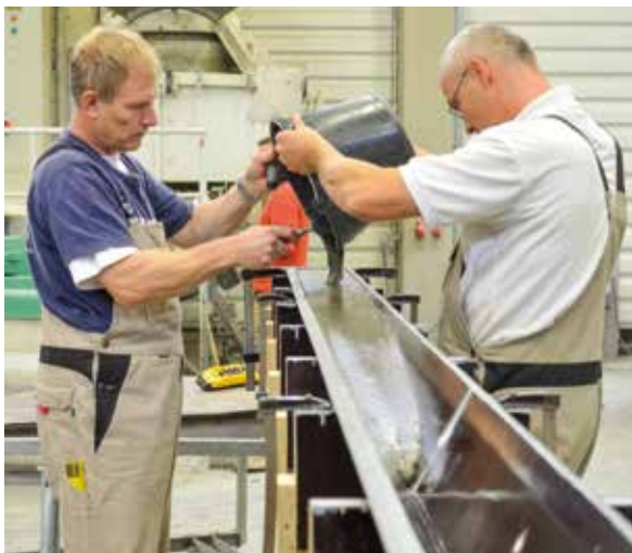
Bild 8: Offene Schalung und liegende Betonage der dreieckigen knickgefährdeten Stütze [Foto: Angela Schmidt]
