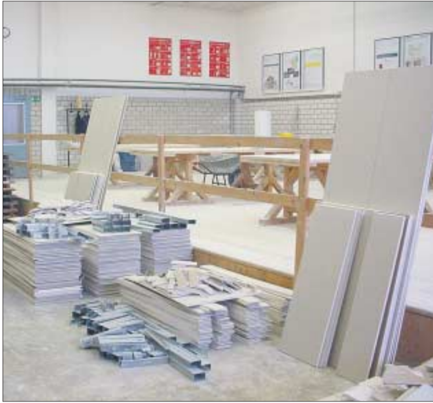
Trockenbauabfall auf einer Baustelle. Durch Abfallmanagement könnte der Bauschutt deutschlandweit um 30 Prozent reduziert werden. Eine an der TUD entwickelte Software hilft dabei. Foto:TUD/Institut für Abfallwirtschaft
