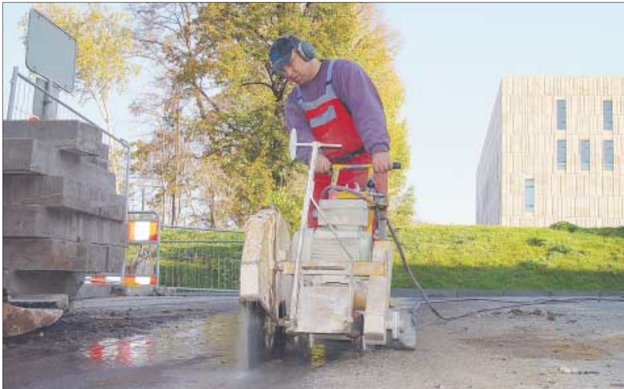
Sägen für die Wissenschaft: Derzeit laufen die Arbeiten für den Trefftz-Anbau auf lautstarken Hochtouren.
