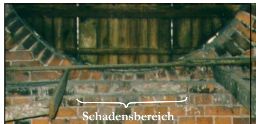
Bild 15 fehlende Ziegel in der Brüstung
