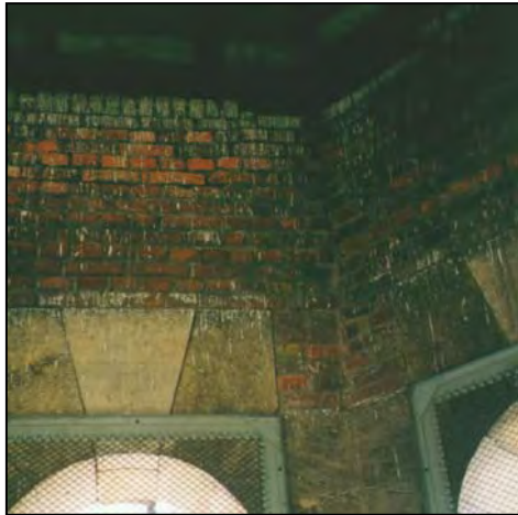
Bild 44 Mauerwerk im Kreuzverband und fehlende Ziegel in der Rollschicht
